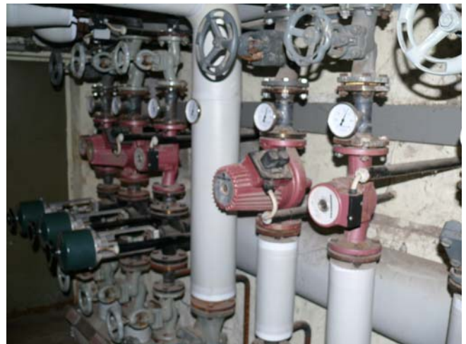
Heizungsverteilung mit alten Pumpen
