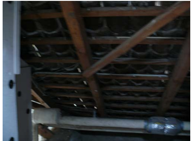
Schlecht gedämmte Heizungsleitungen auf dem Dachboden
