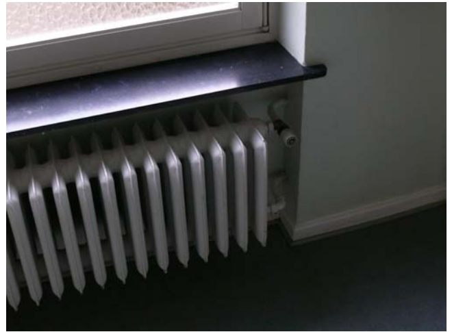
Heizkörpernische und ungedämmte Leitungen im Bädertrakt
