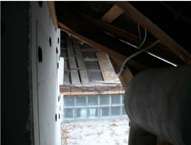
Unzugängliche verschachtelte Ecken auf dem Dachboden
