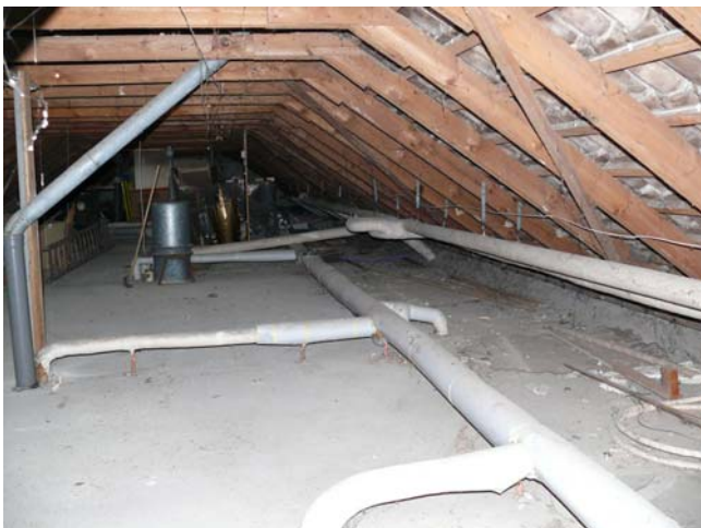
Heizungsleitungen auf den Dachboden
