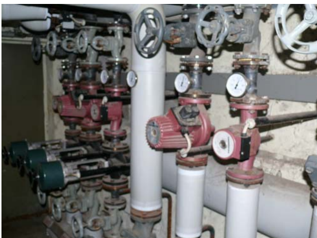
Heizungsverteilung mit alten Pumpen
