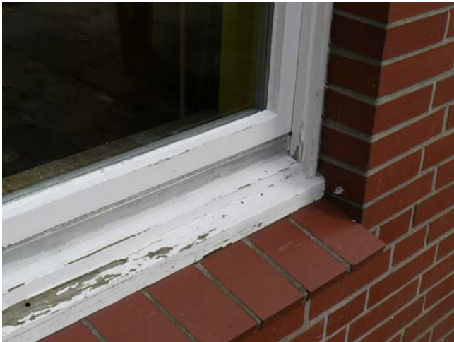
Holzfenster mit deutlichen Lackschäden
