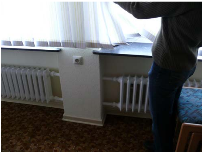
Ungedämmte Leitungen in der Außenwand
