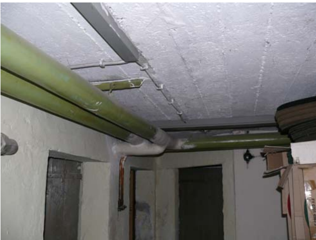
Heizungsleitungen im Keller
